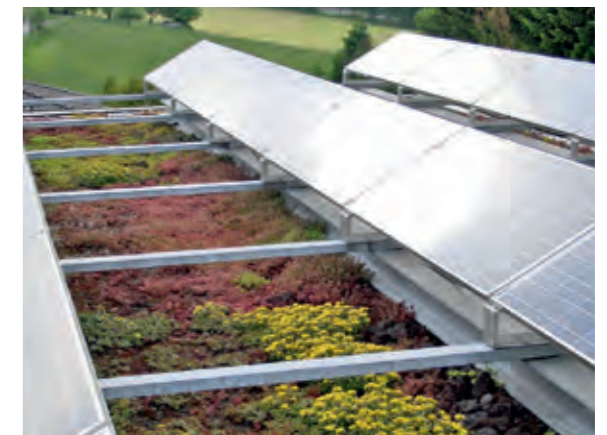
Beispiel: extensive Begrünung mit Photovoltaik-Paneeelen
