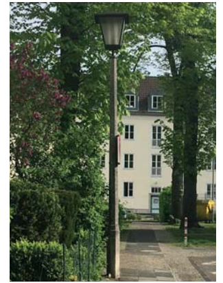
Mastleuchte Bestand Erhalt, ggf. Sanierung
